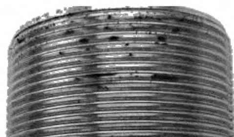
б) Следы коррозии на наружной резьбе
