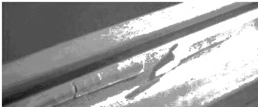
Рисунок А.33 — Отслоение
