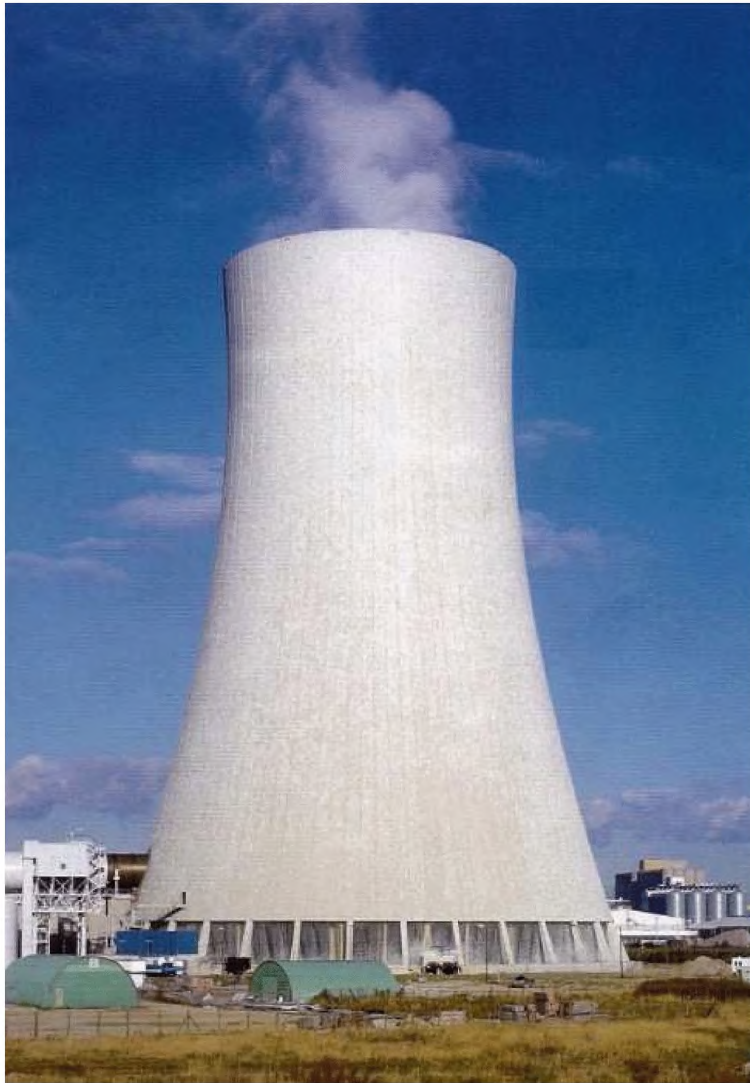
Рисунок 2.9 — Башенная градирня с естественной вентиляцией и противоточным движением потоков воды и воздуха ([9])
