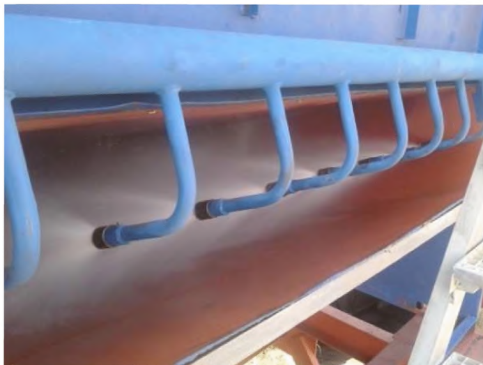
Рисунок 2.15 — Коллектор циркуляционной воды с форсунками эжекционной градирни 3)
